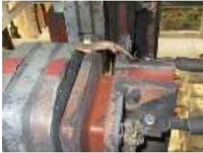
野外受変電設備へのトカゲ侵入 による園内停電
