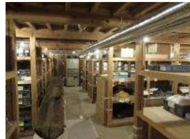
収蔵庫内に設置する空調機と配管
