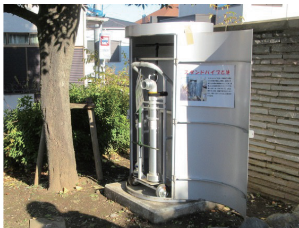
公園に設置されているスタンドパイプとその説明
